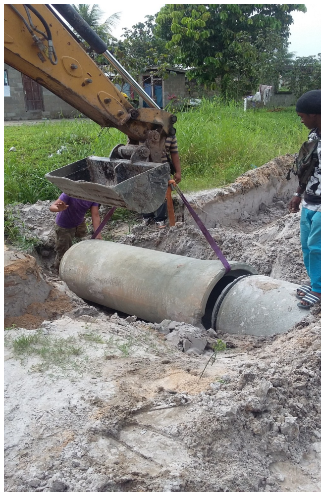
Bij de kruising Pika- en Sabajoweg zijn er duikers geplaatst voor een vlotte stroming van het afvoerwater
